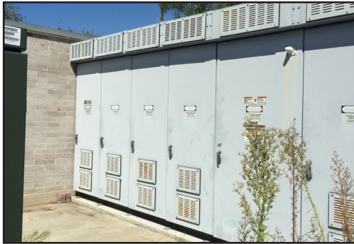
Main 4.16kV Switchgear
