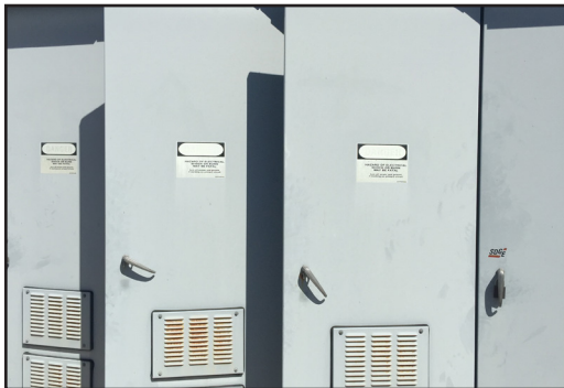
Main 4.16kV Switchgear
